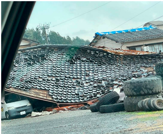
(写真2) 被災状況
