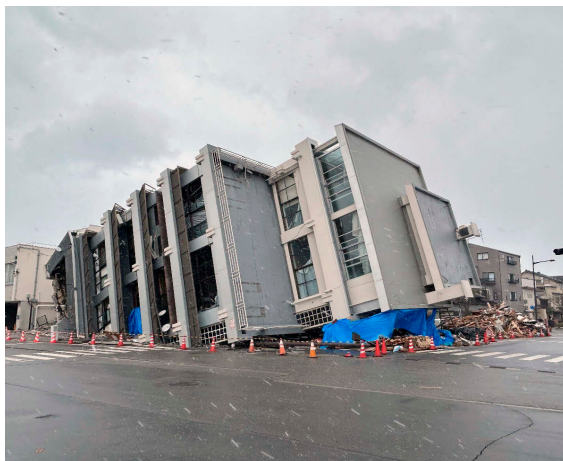
(写真2) 輪島市内の倒壊したビル
